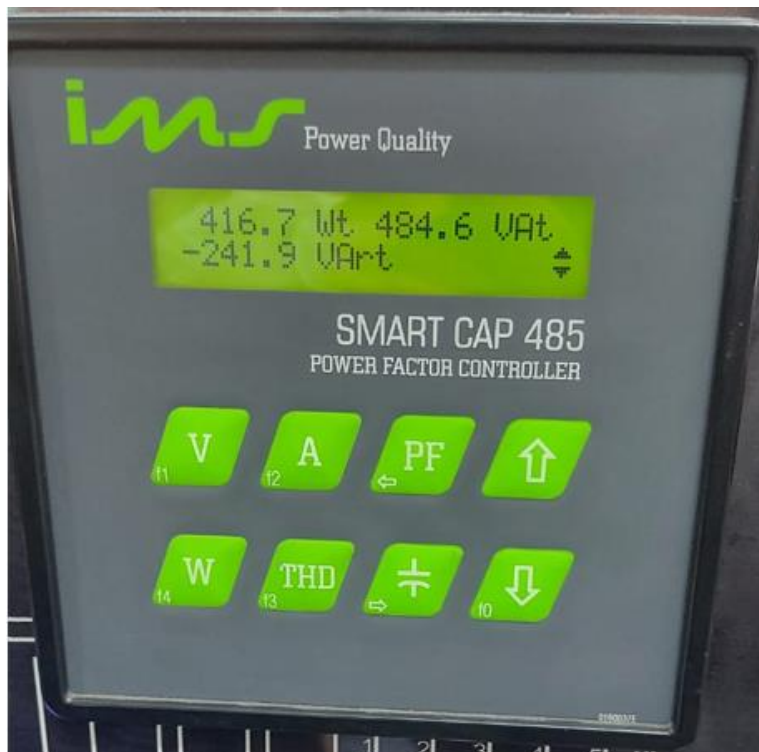
Figura 23 – Potências totais Ativa, Reativa e Aparente Fonte: Arquivo pessoal dos autores
