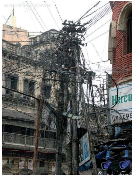
Figura 7.10: Conexões de fios em um poste
