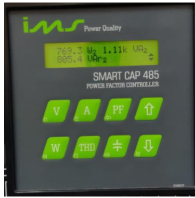
Figura 21 - Potência Ativa, Reativa e Aparente na Fase 2 Fonte: Arquivo pessoal dos autores
