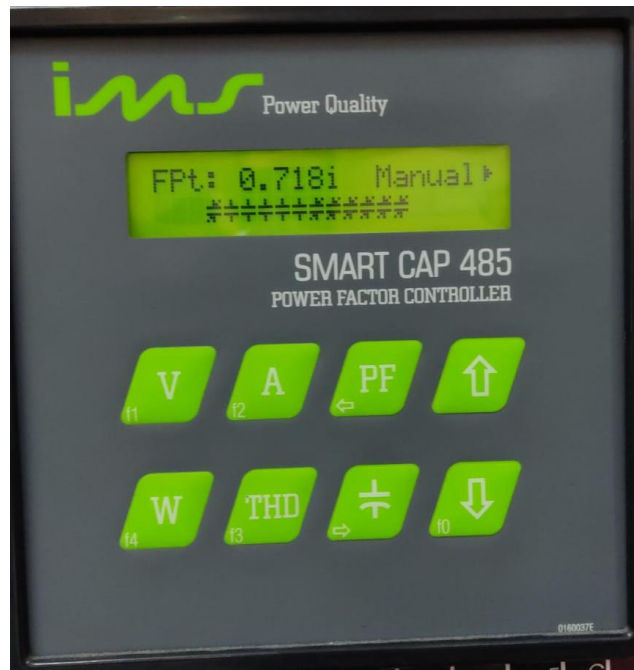
Figura 23 - Fator de potência calculado com o medido no SMART CAP 485 Fonte: Arquivo pessoal dos autores
