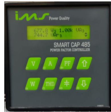
Figura 22 - Potência Ativa, Reativa e Aparente na Fase 3 Fonte: Arquivo pessoal dos autores
