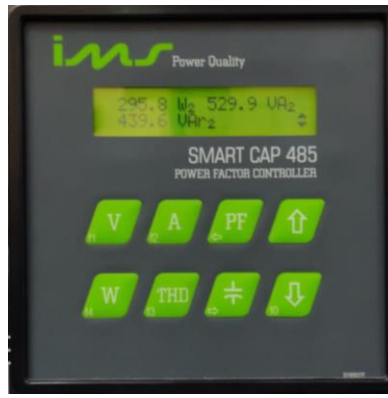
Figura 12 - Potência Ativa, Reativa e Aparente na Fase 2 Fonte: Arquivo pessoal dos autores
