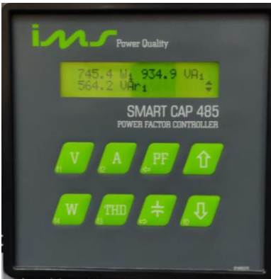
Figura 20 - Potência Ativa, Reativa e Aparente na Fase 1 Fonte: Arquivo pessoal dos autores
