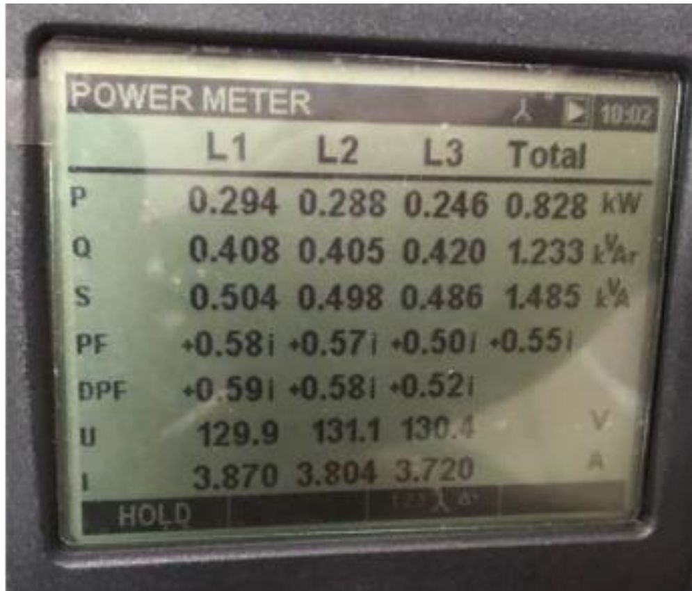
Figura 19 - Valores de potência ativa total, reativa total e aparente total com capacitor de 2,0 kVAr Fonte: Arquivo pessoal dos autores
