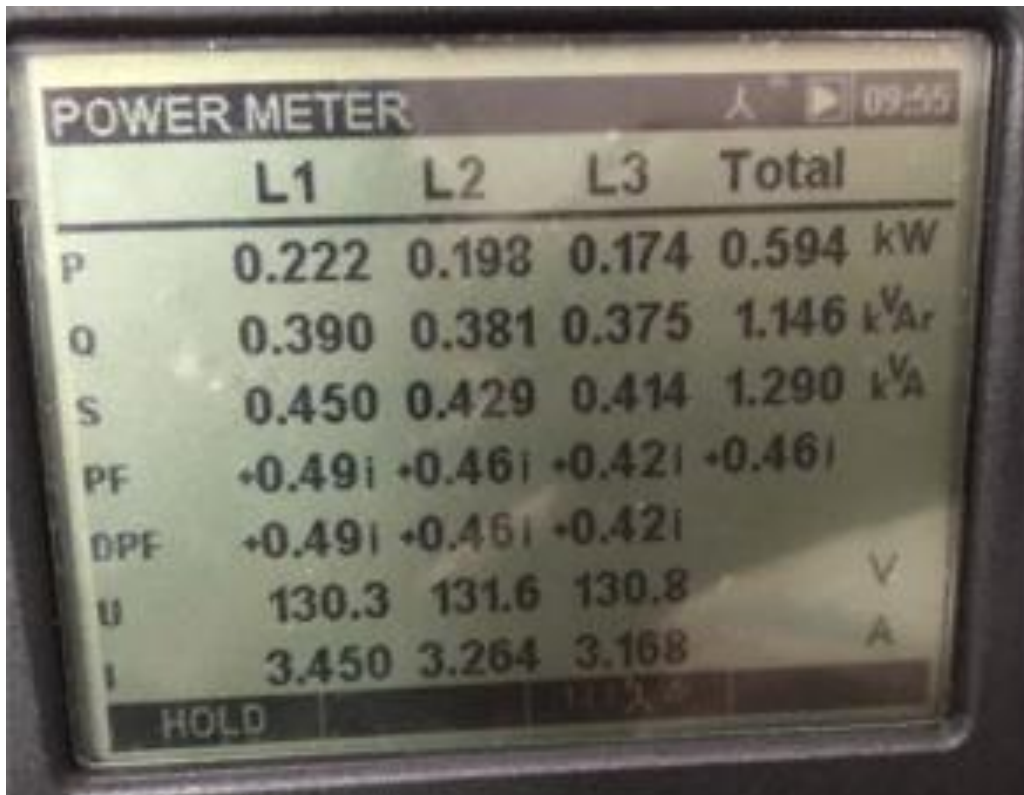
Figura 11 - Valores de potência ativa total, reativa total e aparente total com capacitor de 0,5 kVAr Fonte: Arquivo pessoal dos autores
