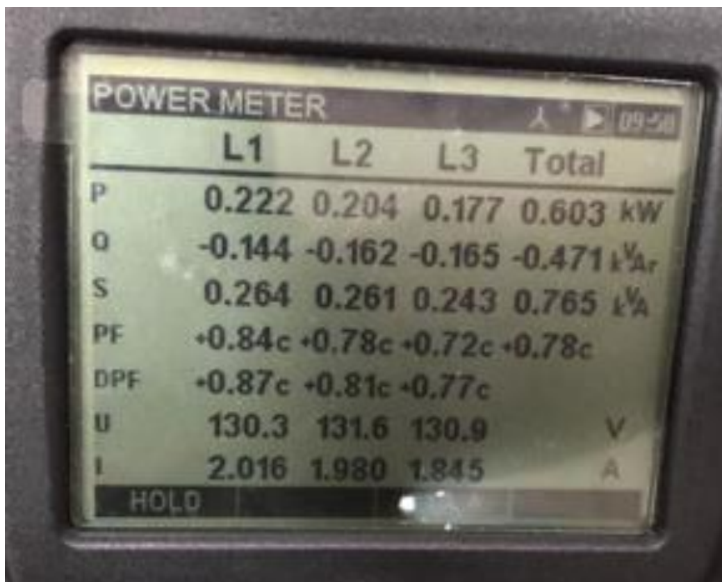
Figura 14 - Valores de potência ativa total, reativa total e aparente total com capacitor de 2,0 kVAr Fonte: Arquivo pessoal dos autores
