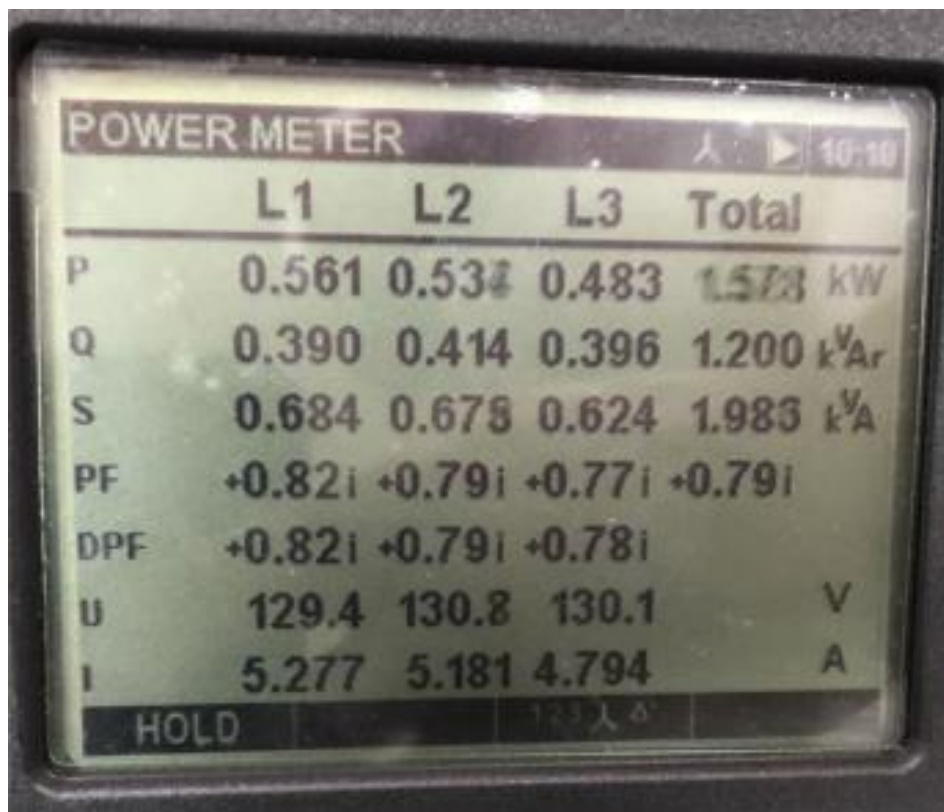
Figura 29 - Valores de potência ativa total, reativa total e aparente total com capacitor de 2,0 kVAr Fonte: Arquivo pessoal dos autores
