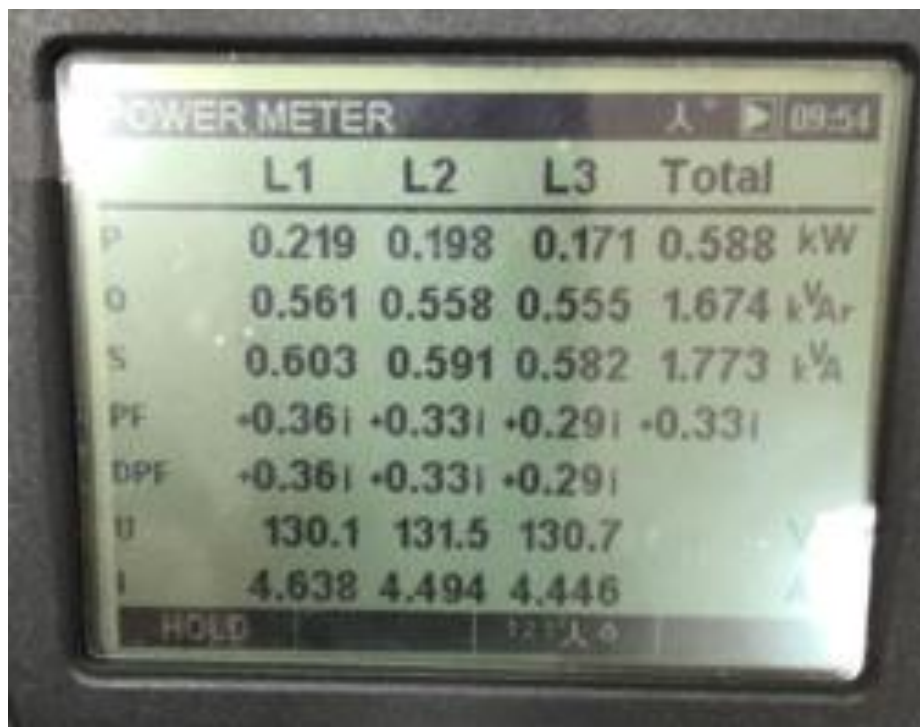
Figura 10 - Valores de potência ativa total, reativa total e aparente total sem carga Fonte: Arquivo pessoal dos autores
