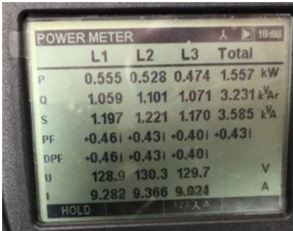
Figura 25 - Valores de potência ativa total, reativa total e aparente total sem correção Fonte: Arquivo pessoal dos autores
