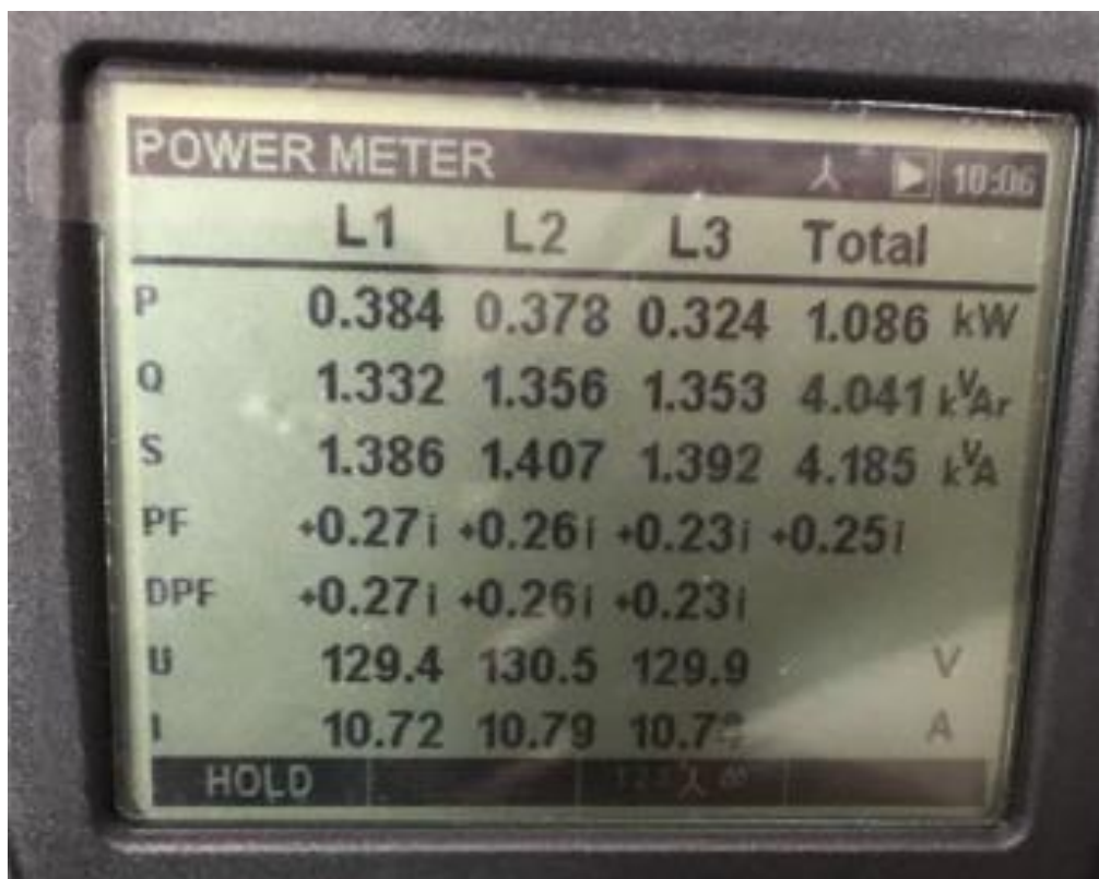
Figura 22 - Valores de potência ativa total, reativa total e aparente total com capacitor de 0,75 kVAr Fonte: Arquivo pessoal dos autores
