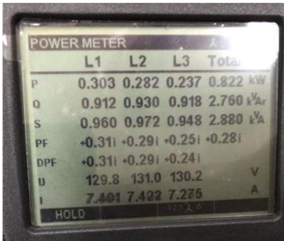
Figura 16 - Valores de potência ativa total, reativa total e aparente total com capacitor de 0,5 kVAR Fonte: Arquivo pessoal dos autores
