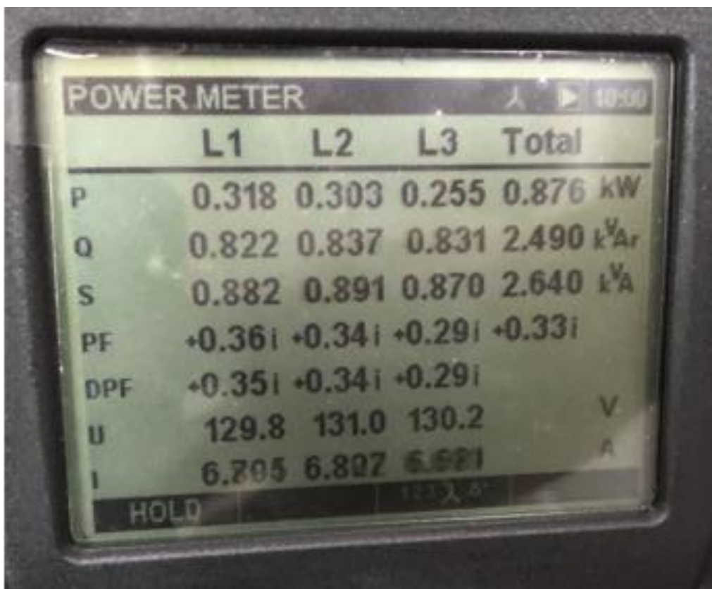
Figura 17 - Valores de potência ativa total, reativa total e aparente total com capacitor de 0,75 kVAr Fonte: Arquivo pessoal dos autores
