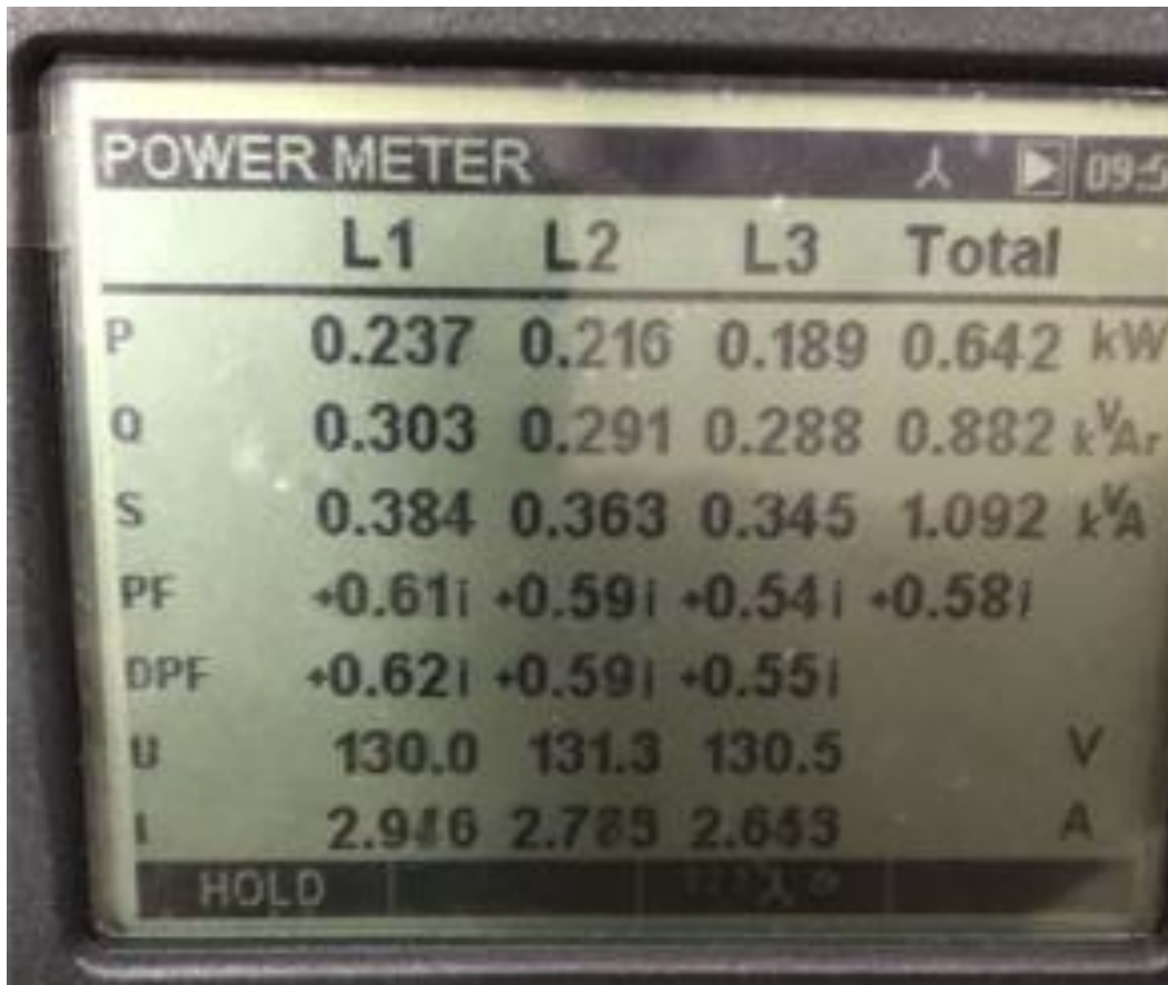
Figura 13 - Valores de potência ativa total, reativa total e aparente total com capacitor de 1,5 kVAr Fonte: Arquivo pessoal dos autores
