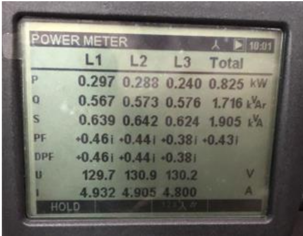
Figura 18 - Valores de potência ativa total, reativa total e aparente total com capacitor de 1,5 kVAr Fonte: Arquivo pessoal dos autores
