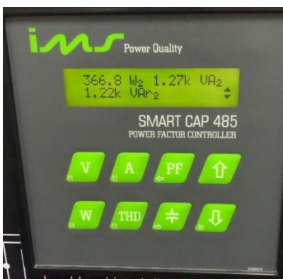
Figura 11 - Potência Ativa, Reativa e Aparente na Fase 2 Fonte: Arquivo pessoal dos autores
