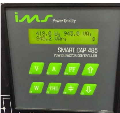
Figura 10 - Potência Ativa, Reativa e Aparente na Fase 1 Fonte: Arquivo pessoal dos autores
