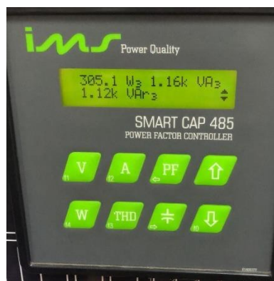
Figura 12 - Potência Ativa, Reativa e Aparente na Fase 3 Fonte: Arquivo pessoal dos autores
