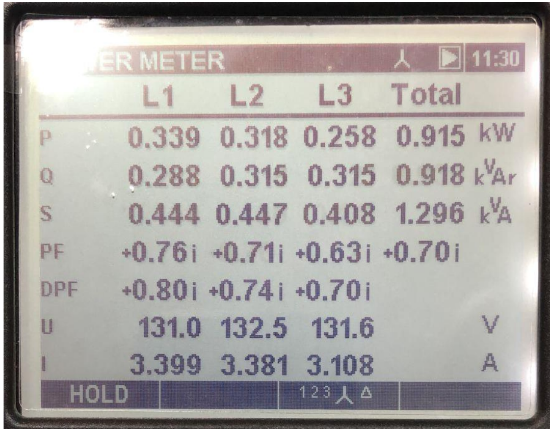
Figura 22 - Valores de tensão e corrente em cada fase Fonte: Arquivo pessoal dos autores
